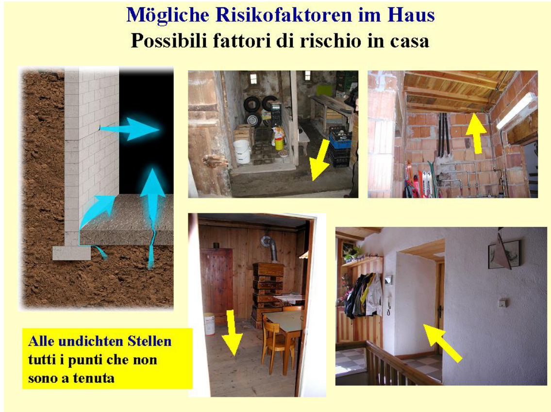
FIGURA 14) La figura riassume alcuni dei fattori che possono facilitare l'ingresso del radon in casa: la cantina con pavimento naturale, un soffitto in legno senza isolamento aggiuntivo, vecchia stube tirolese con pavimentazione in legno, mura di pietrisco molto spesse, mattoni forati in cantina.
